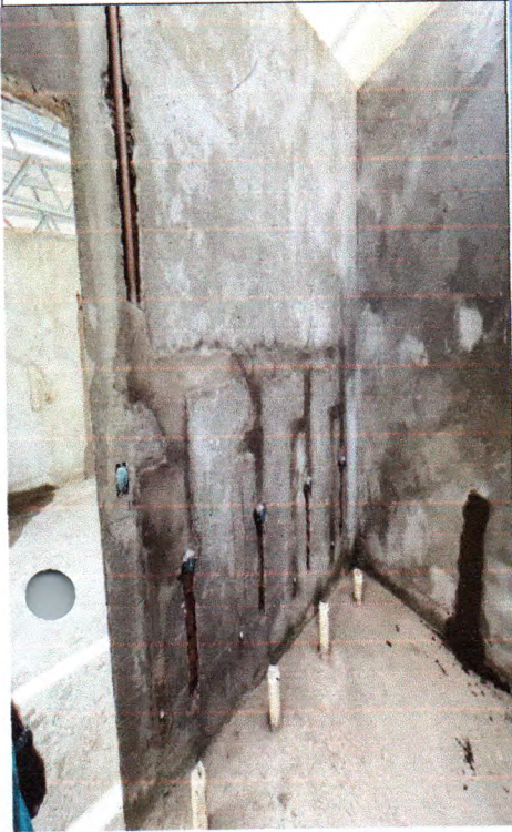
Figura 31: Instalação Sanitária - Tumulação e acessórios
