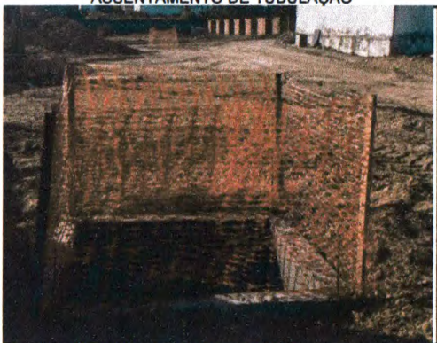
DRENAGEM PROFUNDA - CAIXA DE PASSAGEM
