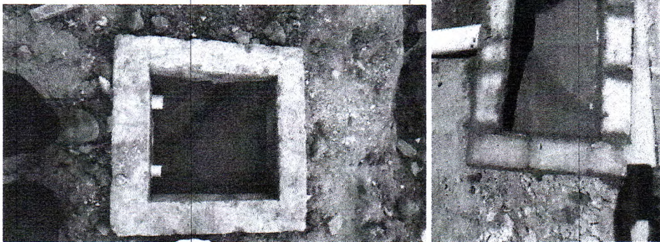
Fotos 01. Caixas de passagem e de gordura
