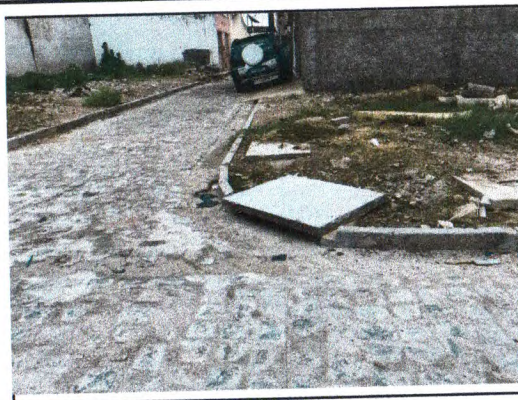
BOCA DE LOBO
