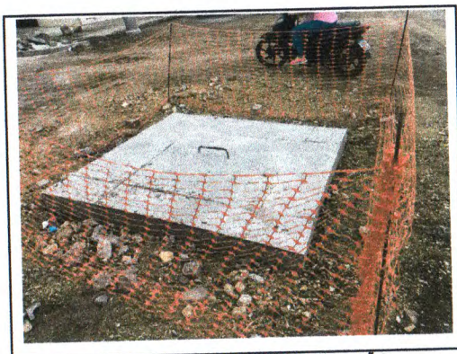
CAIXA DE PASSAGEM E SINALIZAÇÃO
