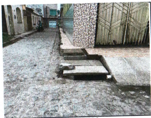
BOCA DE LOBO
