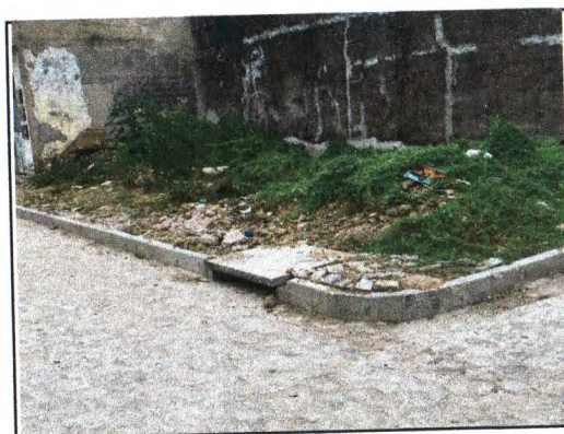
BOCA DE LOBO
