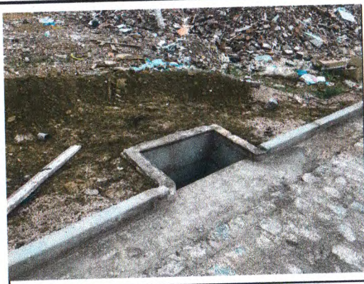
BOCA DE LOBO
