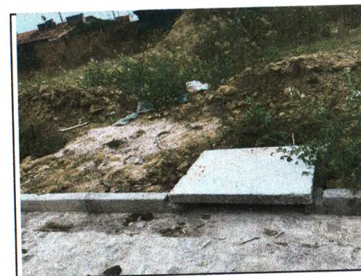
BOCA DE LOBO
