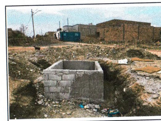
CAIXA DE PASSAGEM
