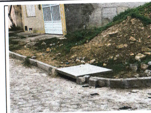
BOCA DE LOBO
