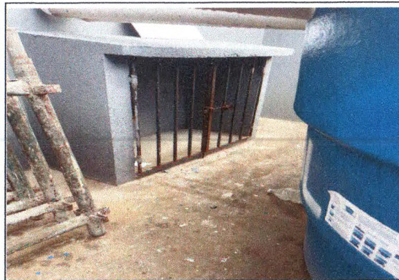
Abrigo de bomba 02
