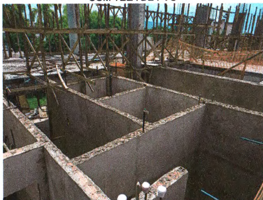
ALVENARIA DE BLOCO CERÂMICO; CHAPISCO E REBOCO INTERNO; ISOLAMENTO COM TELA DE PVC; INSTALAÇÕES ELÉTRICAS
