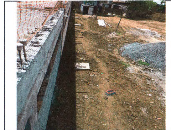
CHAPISCO E REBOCO EXTERNO; CAIXAS DE PASSAGEM EM ALVENARIA E TAMPAS DE CONCRETO
