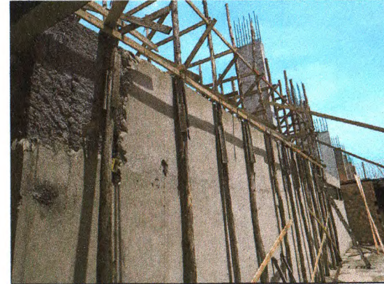
ALVENARIA DE BLOCO CERÂMICO; CHAPISCO; REBOCO EXTERNO; INSTALAÇÕES ELÉTRICAS; ESCORAMENTO EM MADEIRA PARA AS VIGAS
