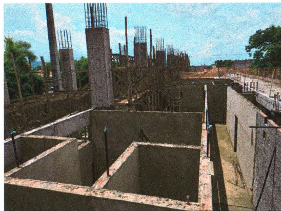
ALVENARIA DE BLOCO CERÂMICO; CHAPISCO E REBOCO INTERNO; ISOLAMENTO COM TELA DE PVC; INSTALAÇÕES ELÉTRICAS
