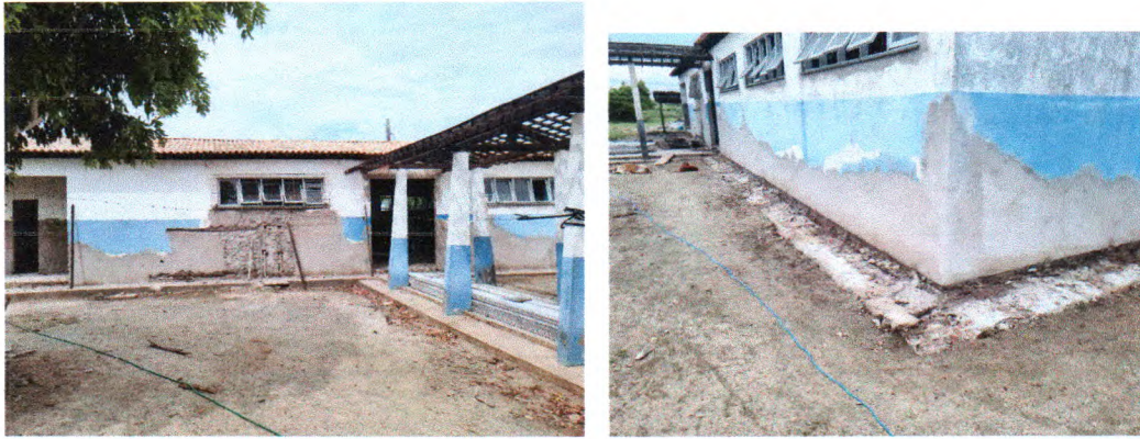
Fotos 06. Execução de telhado, com recolocação das telhas; execução de reboco; demolição de passeio
