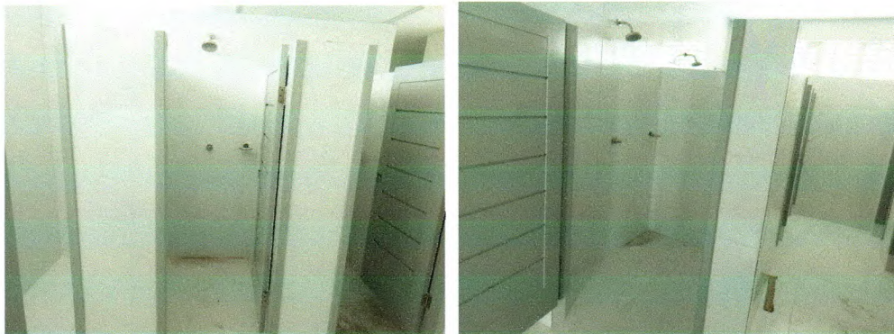
Fotos 01. Instalação de pisos em todo o Bloco do Vestiário e saboneteiras
