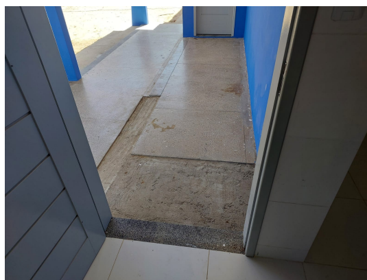
Fotos 02. Soleiras de granito do vestiário e execução de rampas de acesso
