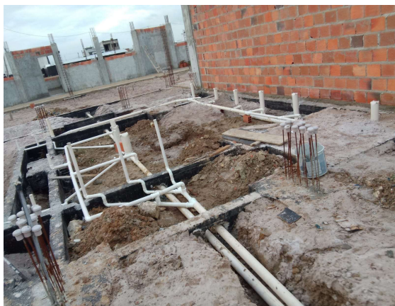
INSTALAÇÕES DE ESGOTO - TUBOS E CONECÇÕES EM PVC
