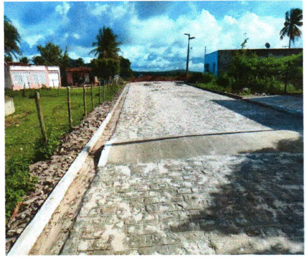
Foto 14: RUA JOSIVAL DOS SANTOS
