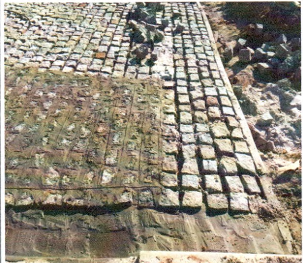
Foto 14: RUA JOSIVAL DOS SANTOS
