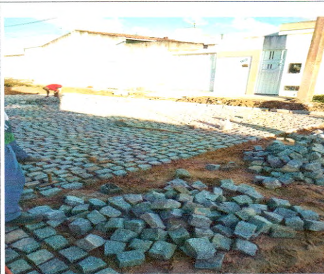
Foto 13: RUA JOSIVAL DOS SANTOS
