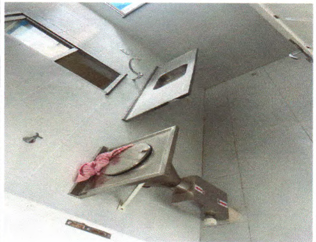
Foto 48: EXPURGO, PIA EM INOX
