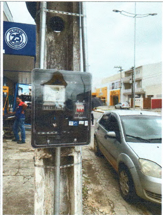
Foto 06: Quadro de medição
